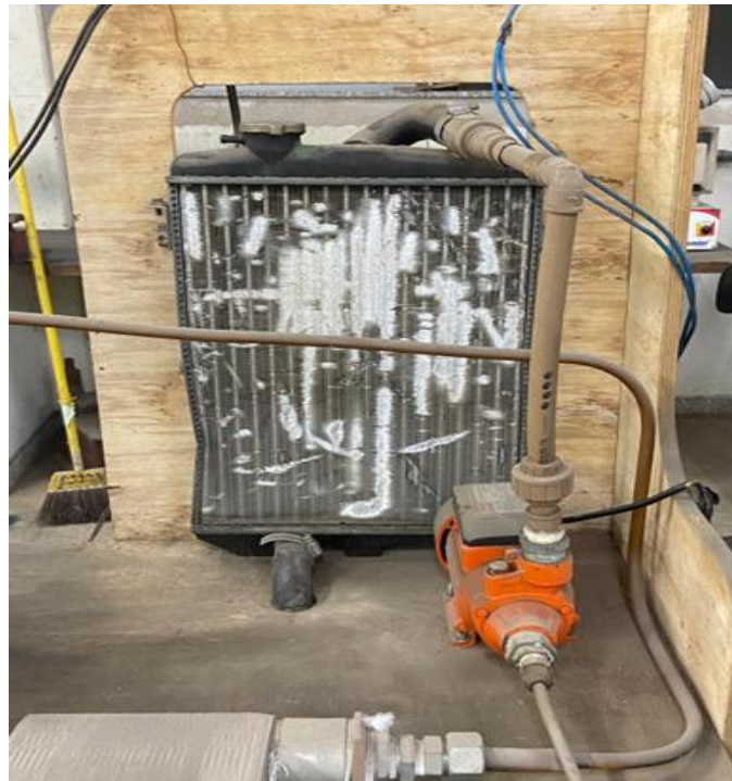
Figura 13 – Radiador e bomba
