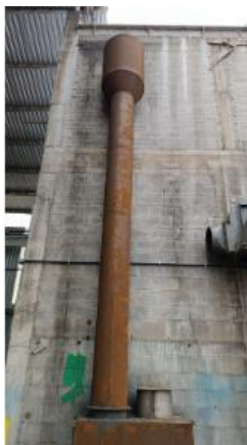
Figura 10: Tubulação de entrada e saída
